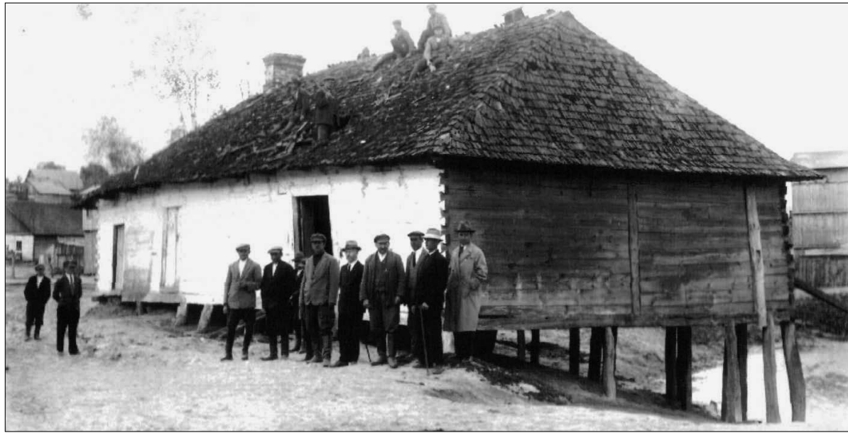
Rozbiórka starej rzeźni miejskiej w Bychawie. Stoją od lewej: radny gminny Baran, radny Kostrzewski, radny Józef Asyngier, sekretarz urzędu gminy Józef Panecki, radny Antoni Frączek, radny Pietras, wójt gminy Stanisław Płaszczewski i ostatni z prawej lekarz weterynarii Wincenty Furmaga
